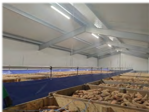
Système air poussé par séchage par condensation
