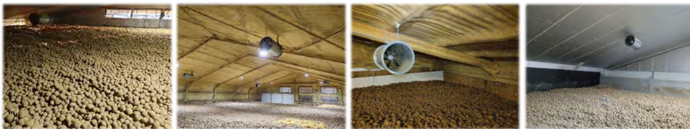
De gauche à droite, photos des aérothermes des bâtiment A, B, C et D
