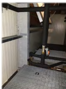
serpentin de chauffage dans le couloir technique (1 er étage)
