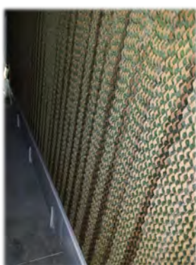
Mur humidificateur au début de la mise en route (début d'écoulement)
