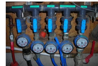
Compteurs d'eau froide
