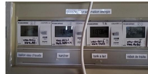
Compteurs dans le tableau électrique
