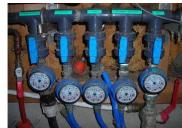
Compteurs d'eau froide
