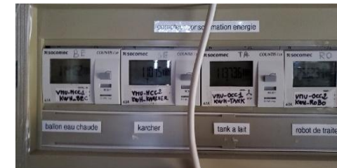
Compteurs dans le tableau électrique
