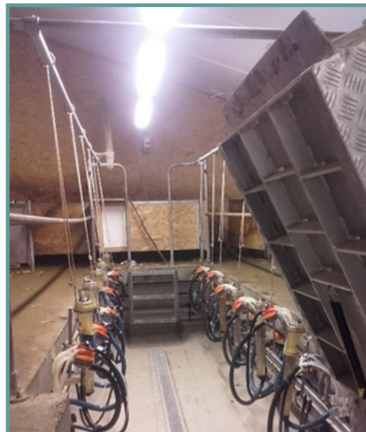
Ligne basse double quai avec 12 postes (2x6) et alimentateur mécanique
