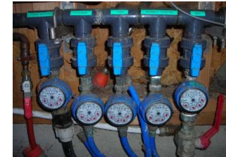
Compteurs d'eau froide
