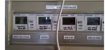
Compteurs dans le tableau électrique
