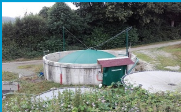
La couverture de fosse couplée à une récupération de biogaz, permet d'économiser de l'énergie.
