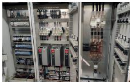
Travaux de modernisation de l'ASA de Martel : Armoire
