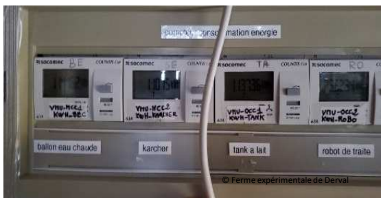
Compteurs dans le tableau électrique
