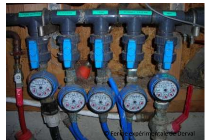
Compteurs d'eau froide
