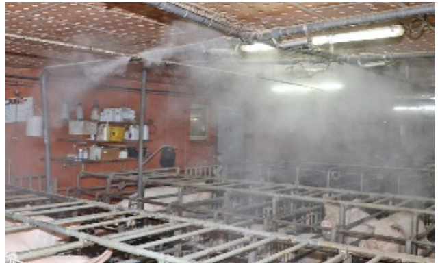
Avec la brumisation, la température dans les bâtiment peut baisser de 2 à 5 °C. ©Chambre d'agriculture de Bretagne
