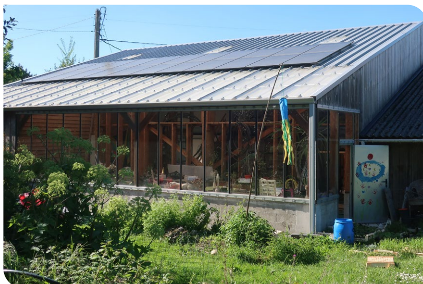
Panneaux photovoltaïques sur le hangar récent.
