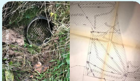
Sorties de drainage à expertiser
