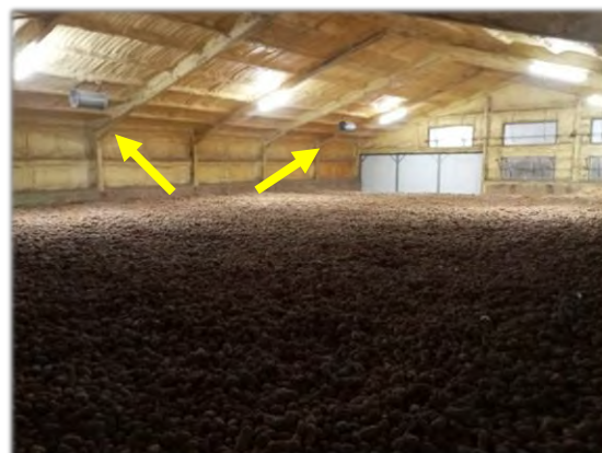
Aérothermes du bâtiment B
