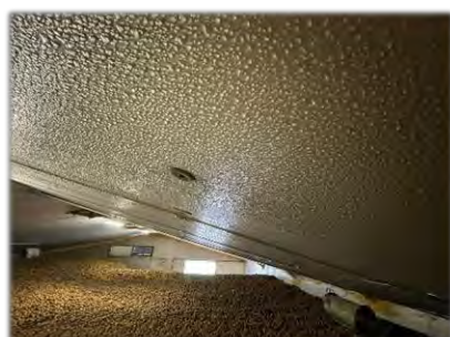
Condensation bâtiment A le 16 octobre
