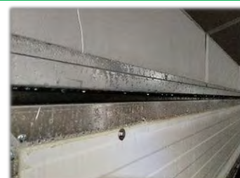
Condensation Bâtiment C le 3 février
