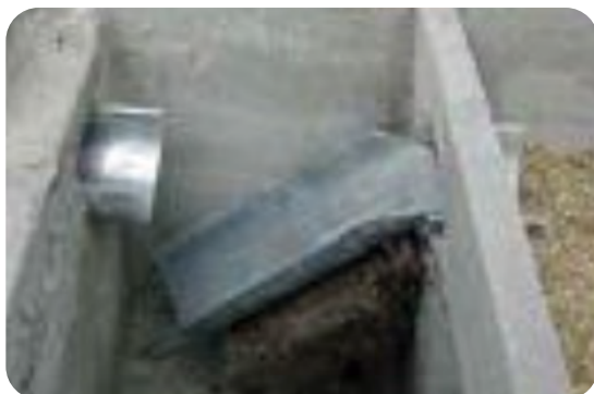
Figure 3 : Disconnecteur avant l'arrivée de la pluie
