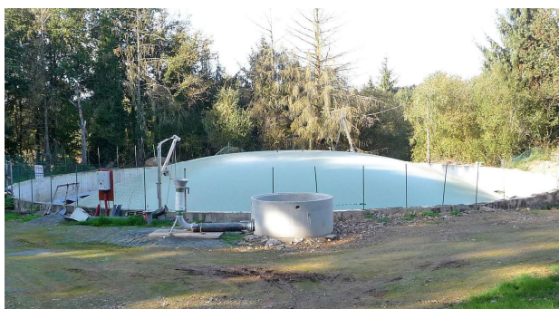
Le rendement de la méthanisation passive est amélioré dans une fosse enterrée par rapport à une fosse aérienne. ©Chambre d'agriculture de Bretagne
