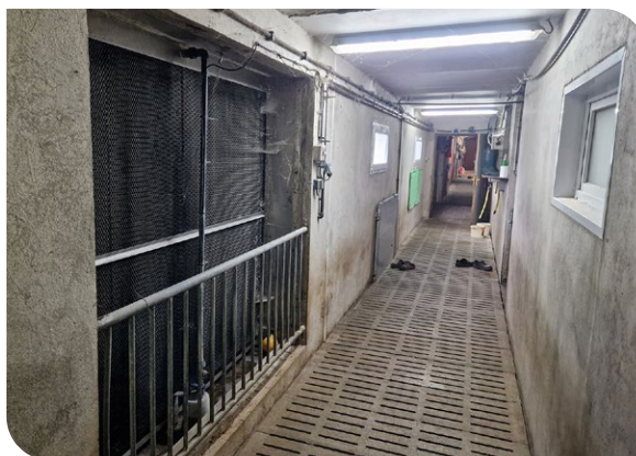
Cooling implanté sur un pan latéral de la porcherie (vues extérieures et intérieures)
