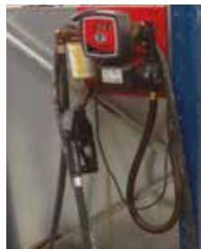
Cuve munie d'un volucompteur (remplissage au hangar)
