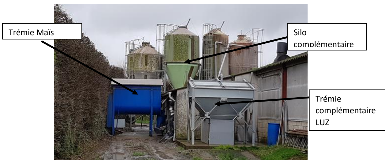
Figure 1 : Installation de stockage et reprise des matières premières en engraissement
