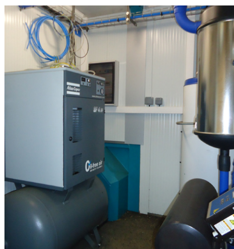
▲ Une zone de la remorque du robot est aménagée en local technique
